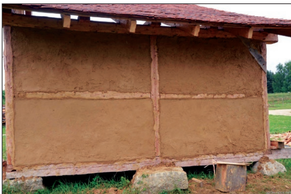
■ Obr. 12 Detail na finální úpravu stěny. Po výpletu nanesená mazanice, v dolních partiích již zahlazená.
